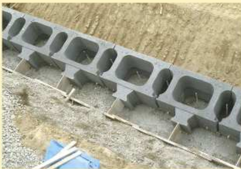
⑤ブロック背面を設計書に基づいた裏込め材料で埋め戻し、ブロック形状・裏込コンクリートの有無に応じ抜き型枠を設置
